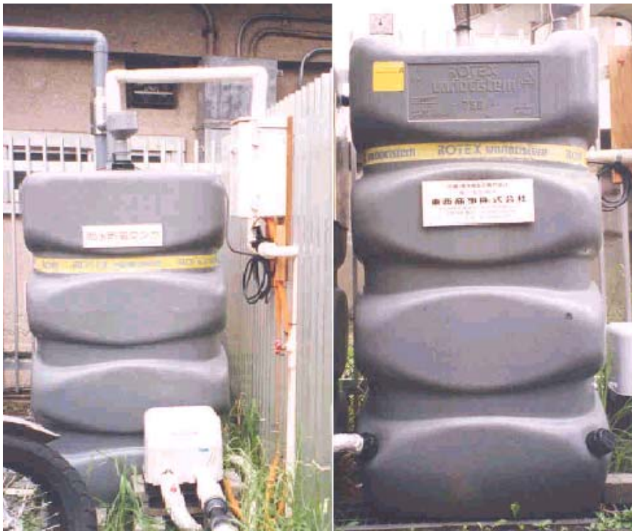
<사진 4-3> 빗물 펌프장 관리인 휴게소에 설치된 빗물 탱크
