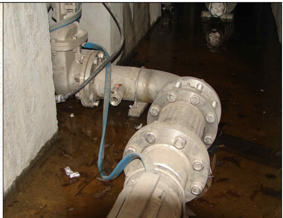
협소한 설치공간과 관리곤란
