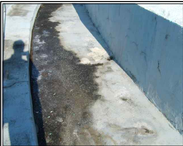
<사진 5-19> 지붕층 바닥 상부 ROOF DRAIN 배수상태 불량
