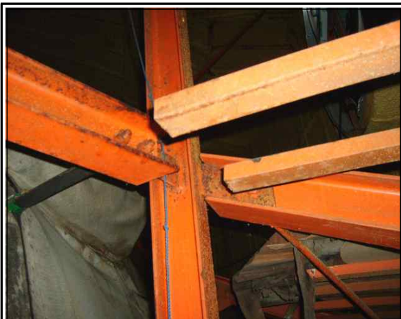
<사진 5-21> 지붕층 철골 부재 녹 발생 현황 (볼트 체결 등 접합부 상태 양호)
