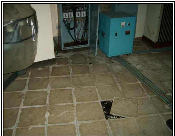
<사진 5-20> 2층 영사실 바닥 타일탈락 현황
