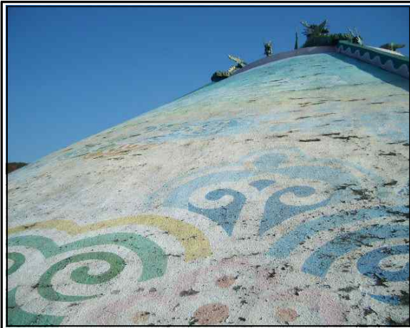
<사진 5-17> 지붕층 바닥 상부 도장탈락 및 풍화 현황
