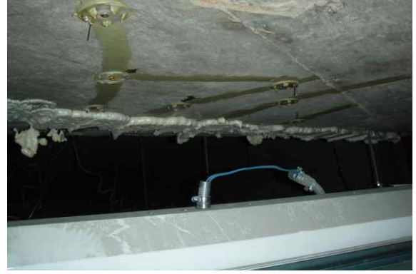
<그림 2.2-3> 도면 지하1층 X2~3-Y2~3열 슬래브 균열 보수상태(에폭시, 우레탄)
