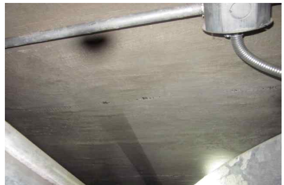
<그림 2.2-5> 도면 지하1층 X8~10-Y'08A열 슬래브 탄소섬유 보강상태
