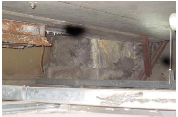
<그림 2.2-10> 도면 지하1층 X7-Y1~2열 누수발생 흔적상태
