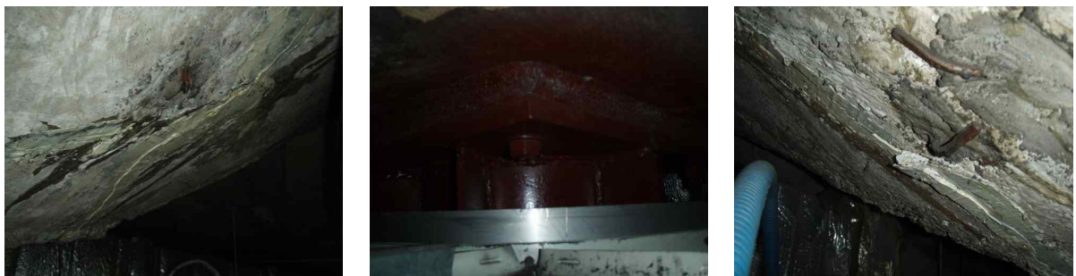
<그림 2.2-7> 도면 지하층 X4-Y1열 기둥 보강 및 기둥 상단 좌, 우측 헌치의 손상, 균열보수 상태(균열 보수 후 재 발생)
