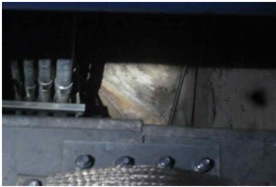
<그림 2.2-9> 도면 지하1층 X9~10-Y5열 벽체 현치부위 누수흔적
