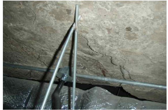
<그림 2.2-5> 도면 지하1층 X22~23-Y2열 드롭판넬의 콘크리트 층분리 상태
