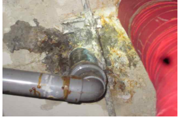
<그림 2.2-8> 도면 지하1층 X1~2-Y2~3열 배관주변 누수 흔적 및 백태상태
