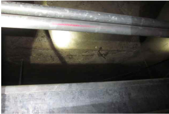
<그림 2.2-4> 도면 지하1층 X19~20-Y4열 슬래브의 재료분리 및 표면바리 상태
