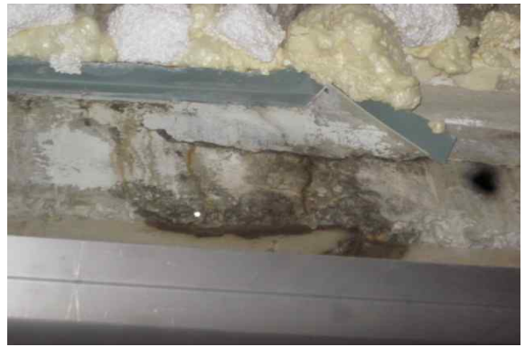
<그림 2.2-10> 도면 지하1층 X1-Y3~4열 누수부위 유도배수처리 상태
