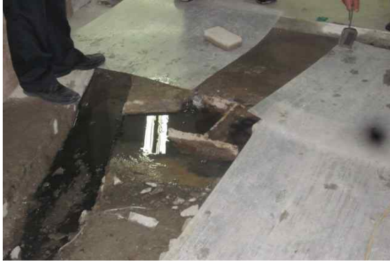
<그림 2.2-7> 도면 지하1층 X1~2-Y'5열 H-형강 절단부위 바닥 누수상태
