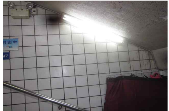
<그림 2.2-7> 도면 지하1층 X11~12-Y1a열 벽체면의 누수 흔적상태
