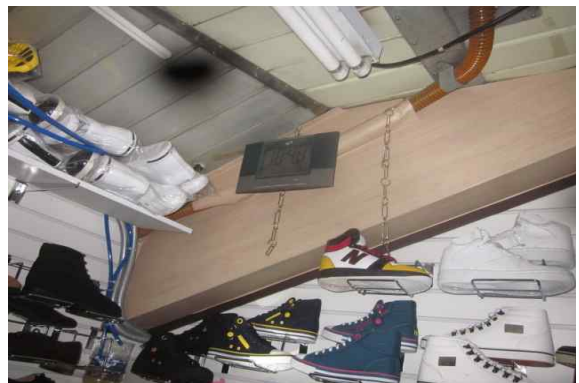
<그림 2.2-5> 도면 지하1층 X12열 누수에 따른 유도처리 상태
