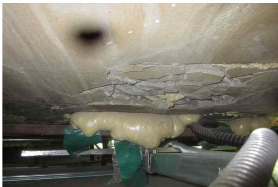
<그림 2.2-4> 도면 지하1층 X12열 슬래브 마감 몰탈 들뜸 및 박리 상태
