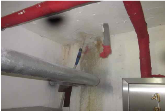
<그림 2.2-6> 도면 지하1층 X13~14-A~B열 배관주위 누수상태
