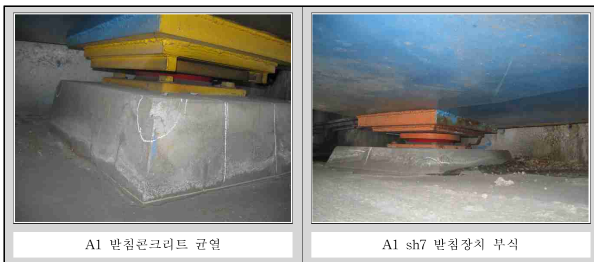
【표 2.1.7】 받침장치 손상 및 결함내용
