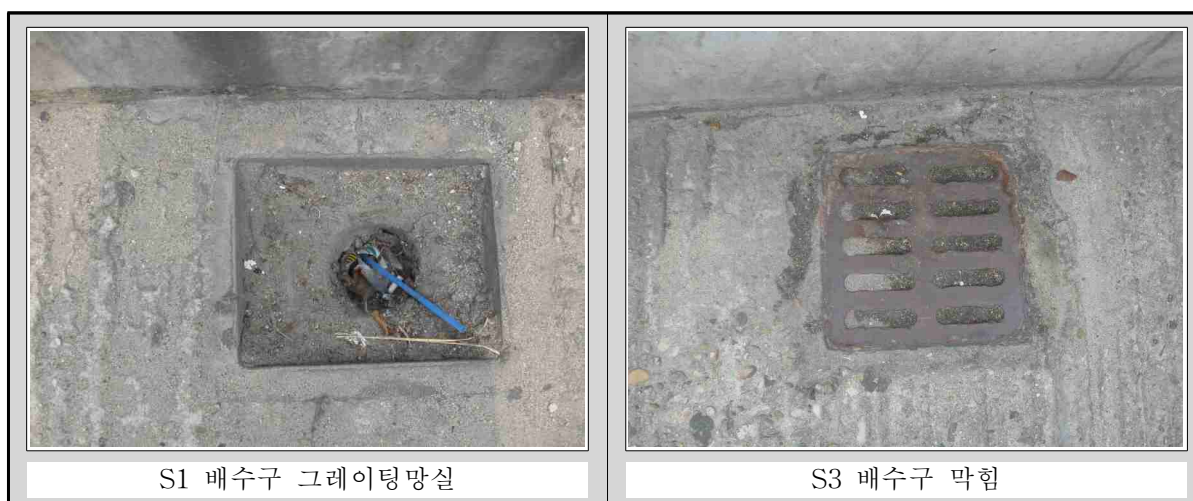
【표 2.1.13】 배수시설 손상 및 결함내용
