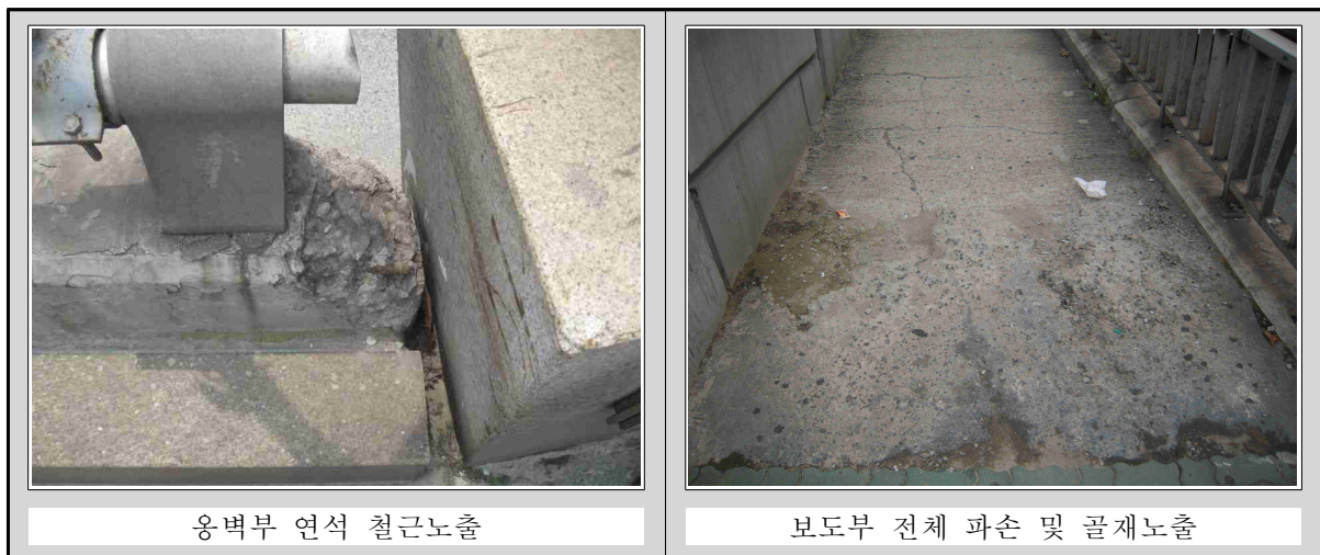
【표 2.1.15】 난간 및 연석 손상 및 결함내용
