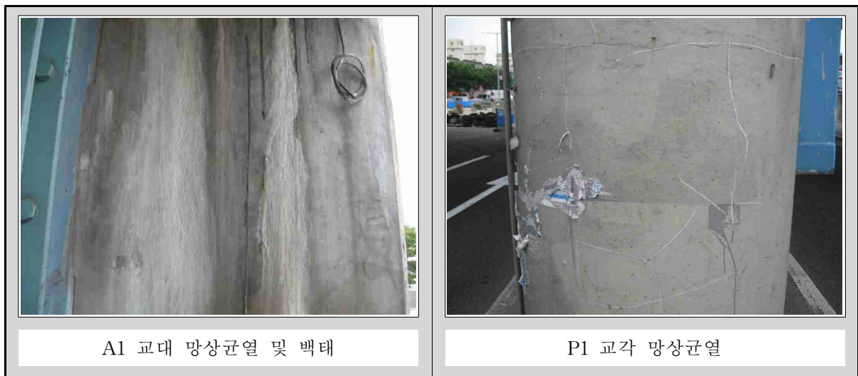
【표 2.1.5】 교대 및 교각 손상 및 결함내용
