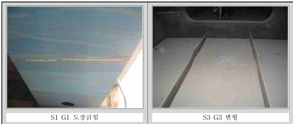
【표 2.1.3】 거더 및 가로보 손상 및 결함내용
