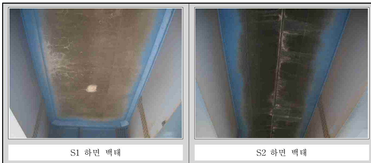
【표 2.1.1】 콘크리트 바닥판 손상 및 결함내용
