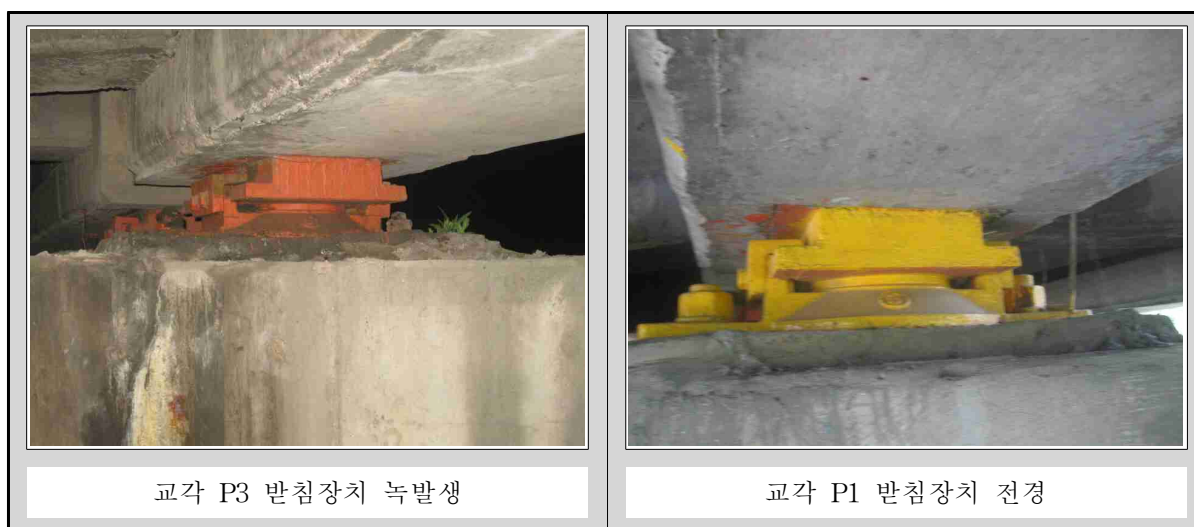
【표 2.1.7】 받침장치 손상 및 결함내용
