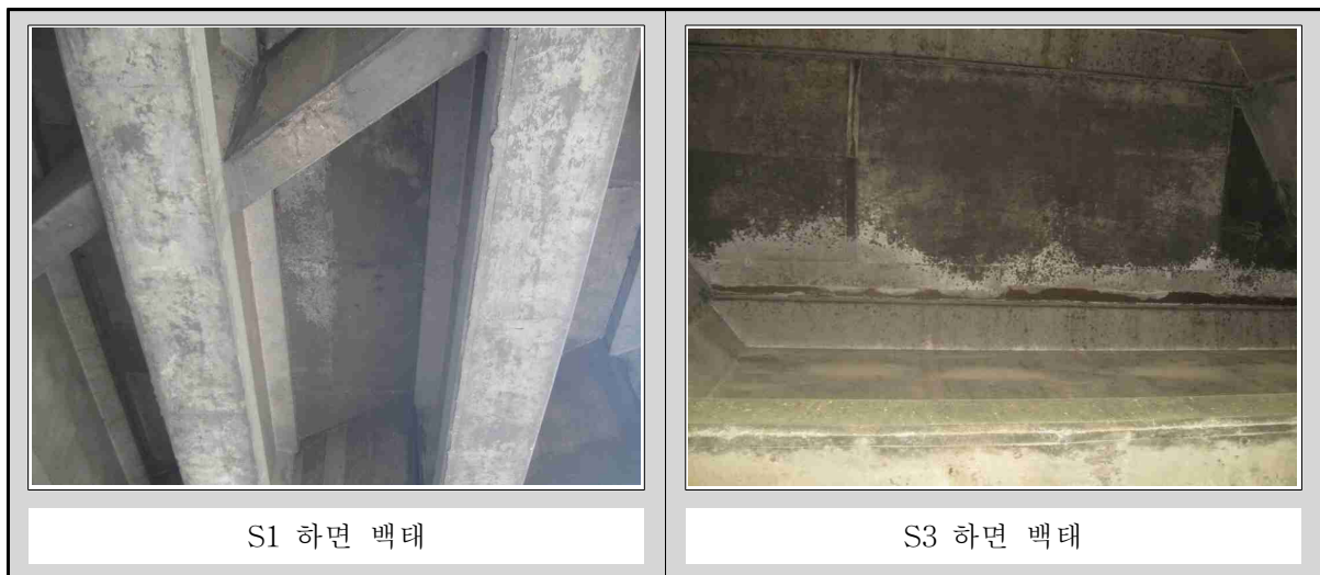
【표 2.1.1】 콘크리트 바닥판 손상 및 결함내용
