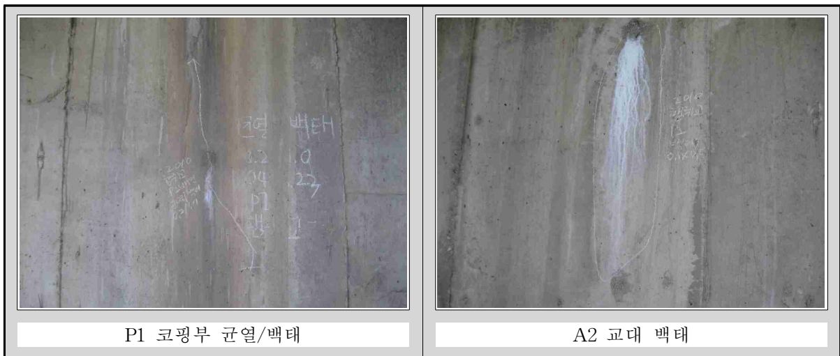
【표 2.1.5】 교대 및 교각 손상 및 결함내용
