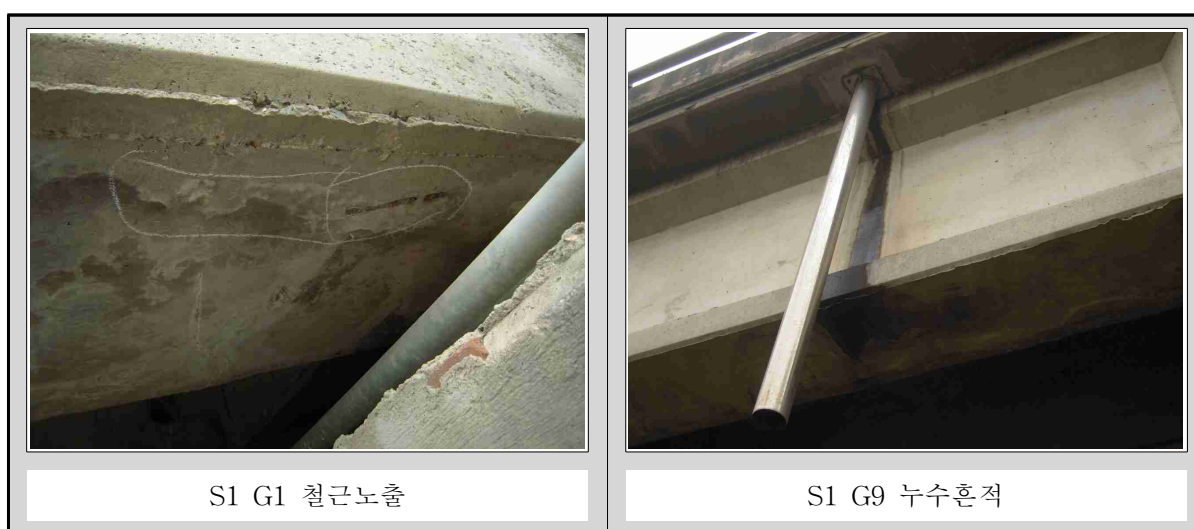
【표 2.1.3】 거더 및 가로보 손상 및 결함내용
