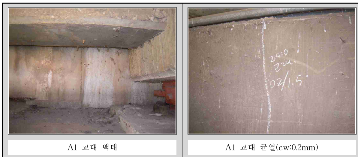
【표 2.1.5】 교대 손상 및 결함내용
