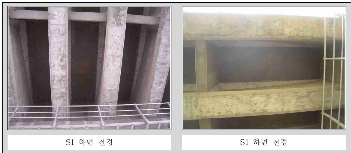
【표 2.1.1】 콘크리트 바닥판 손상 및 결함내용
