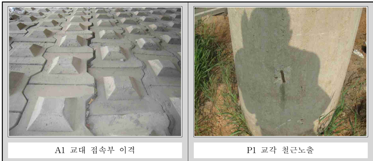
【표 2.1.19】 교대 및 교각 손상 및 결함내용
