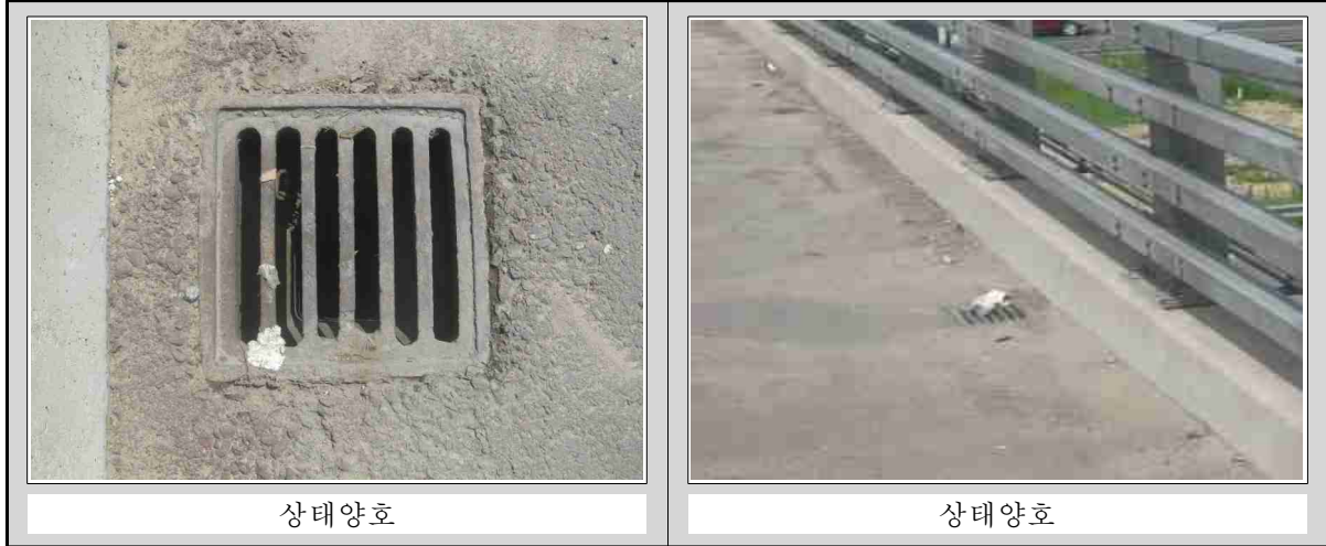
【표 2.1.13】 배수시설 손상 및 결함내용
