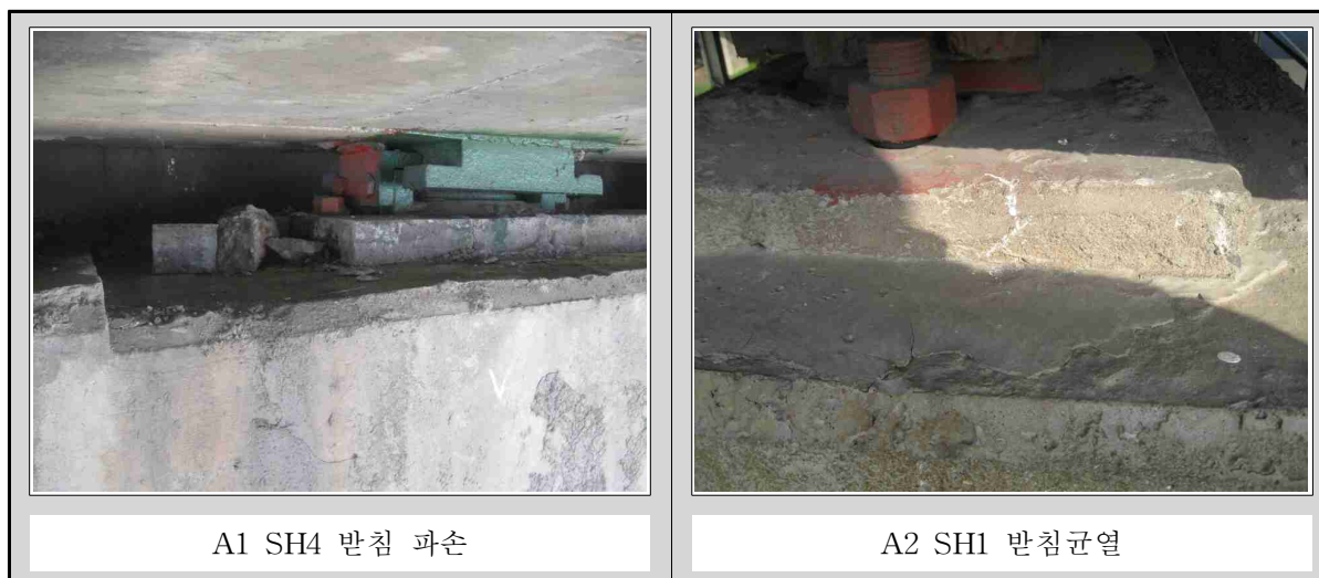
【표 2.1.21】 받침장치 손상 및 결함내용
