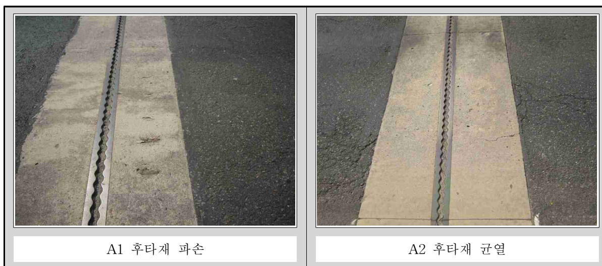
【표 2.1.23】 신축이음장치 손상 및 결함내용
