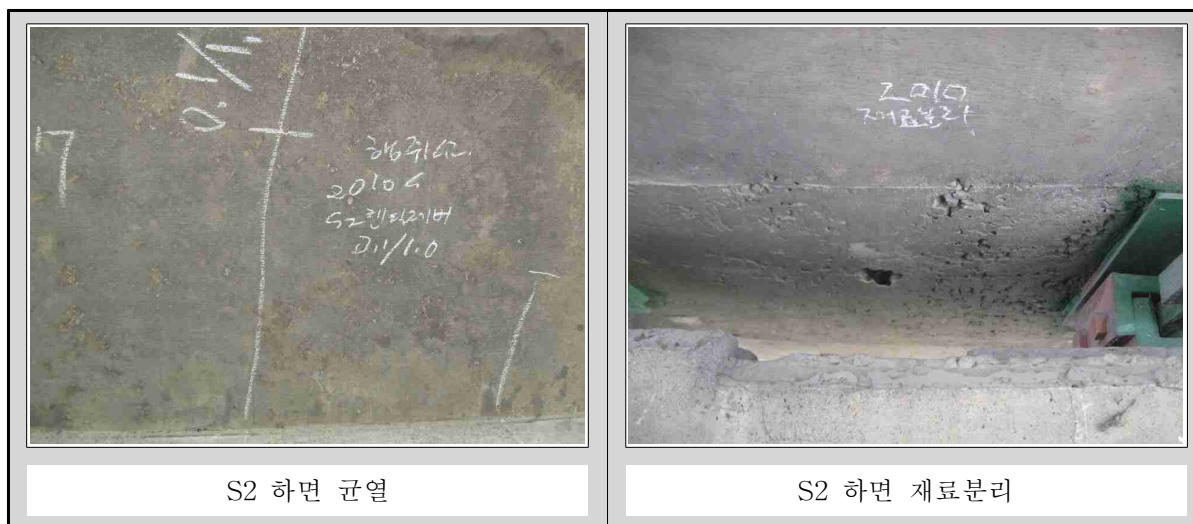
【표 2.1.17】 콘크리트 바닥판 손상 및 결함내용
