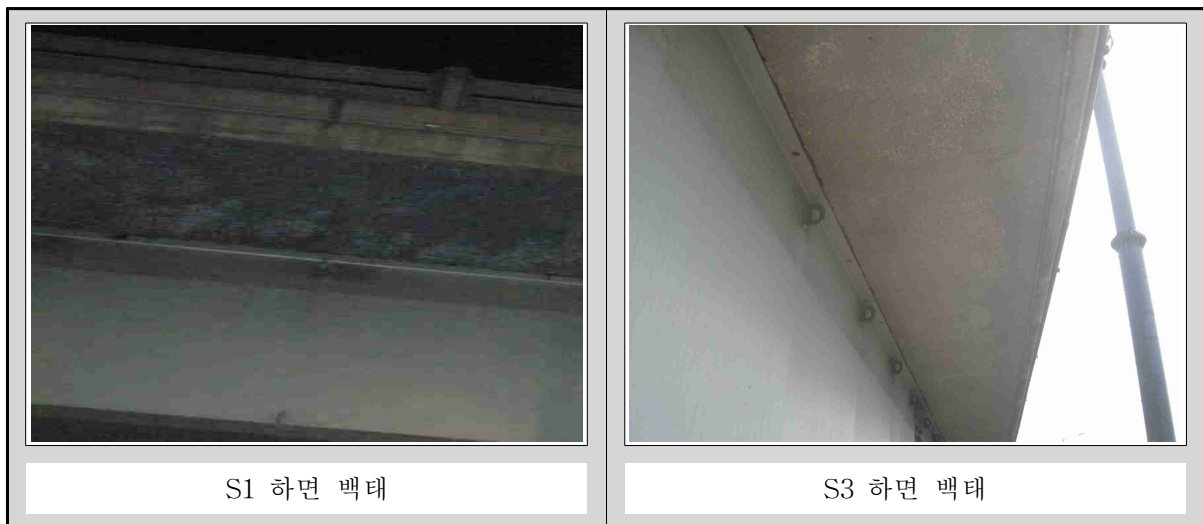
【표 2.1.1】 콘크리트 바닥판 손상 및 결함내용
