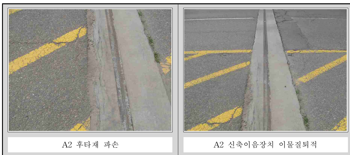
【표 2.1.9】 신축이음장치 손상 및 결함내용
