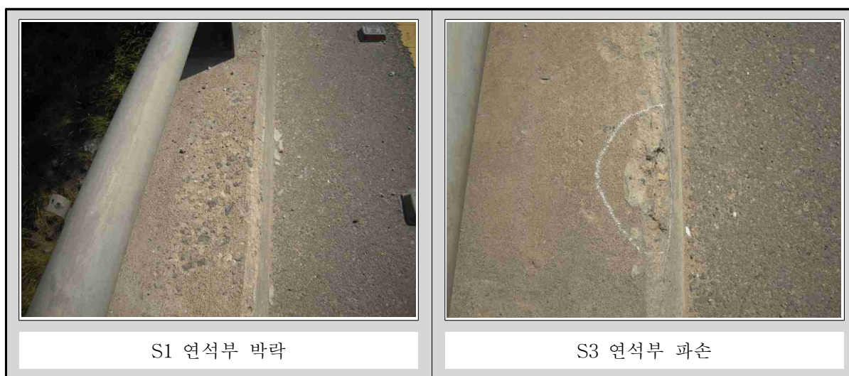
【표 2.1.29】 난간 및 연석 손상 및 결함내용
