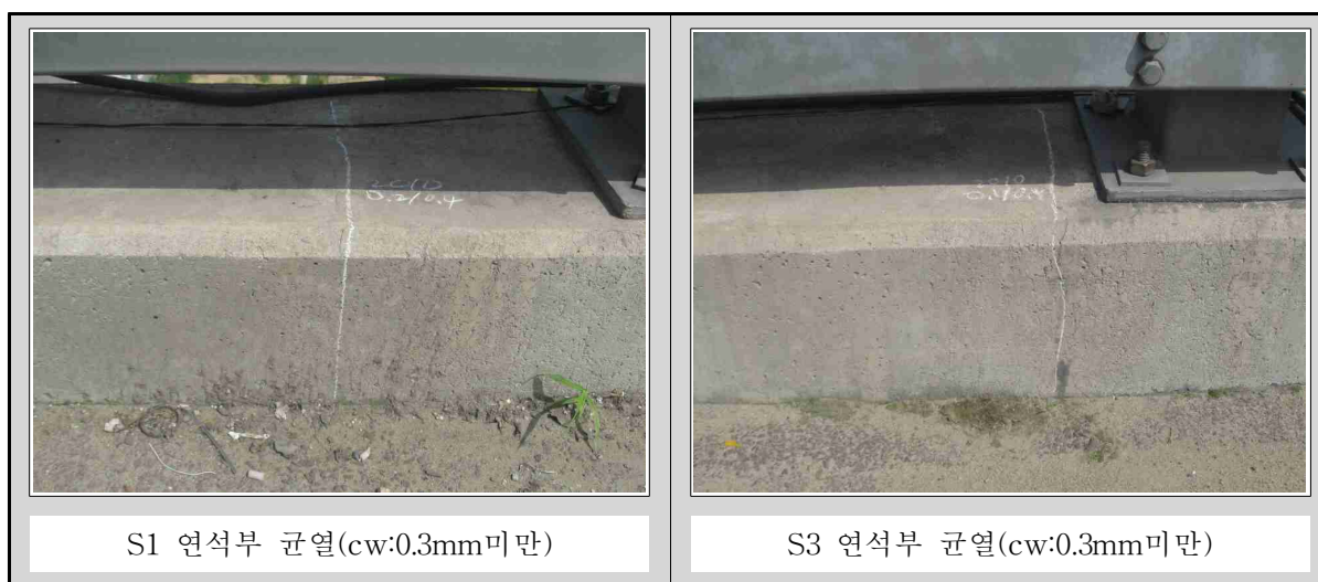
【표 2.1.15】 난간 및 연석 손상 및 결함내용
