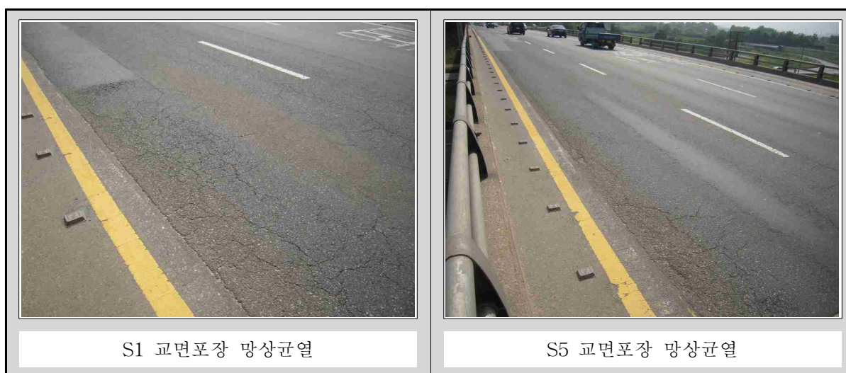
【표 2.1.25】 교면포장 손상 및 결함내용
