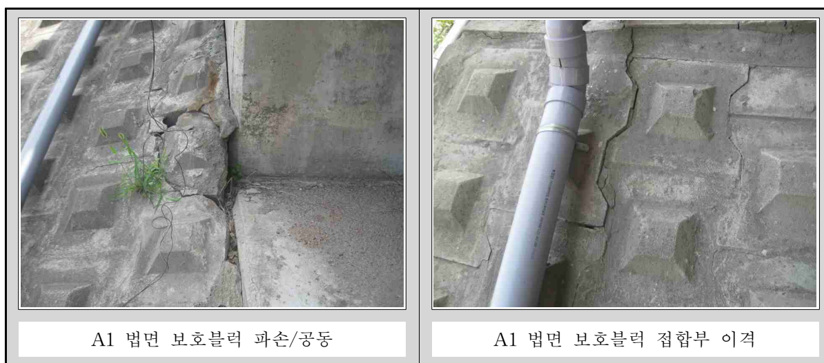
【표 2.1.5】 교대 및 교각 손상 및 결함내용
