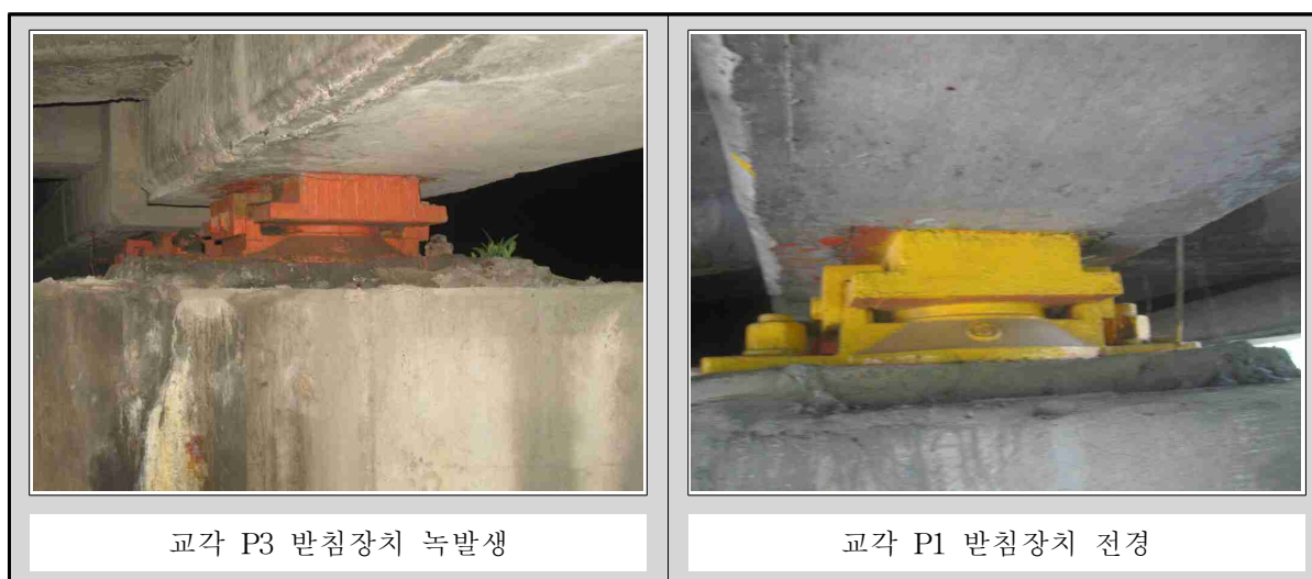
【표 2.1.7】 받침장치 손상 및 결함내용
