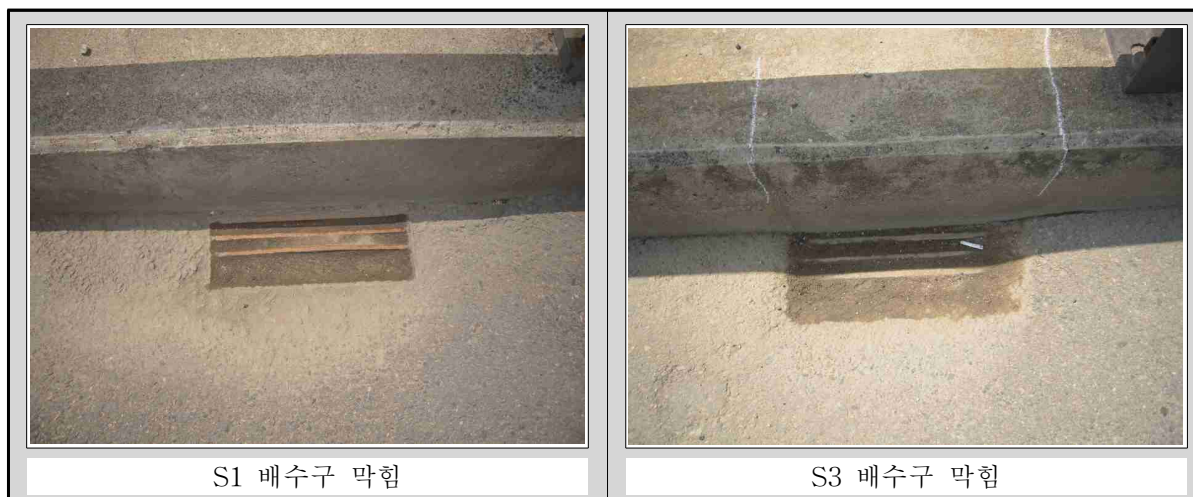
【표 2.1.27】 배수시설 손상 및 결함내용
