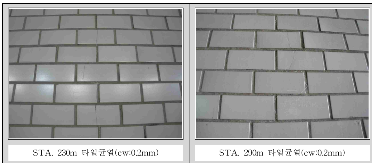
【표 2.1.3】 본선BOX 구간 벽체 손상 및 결함내용
