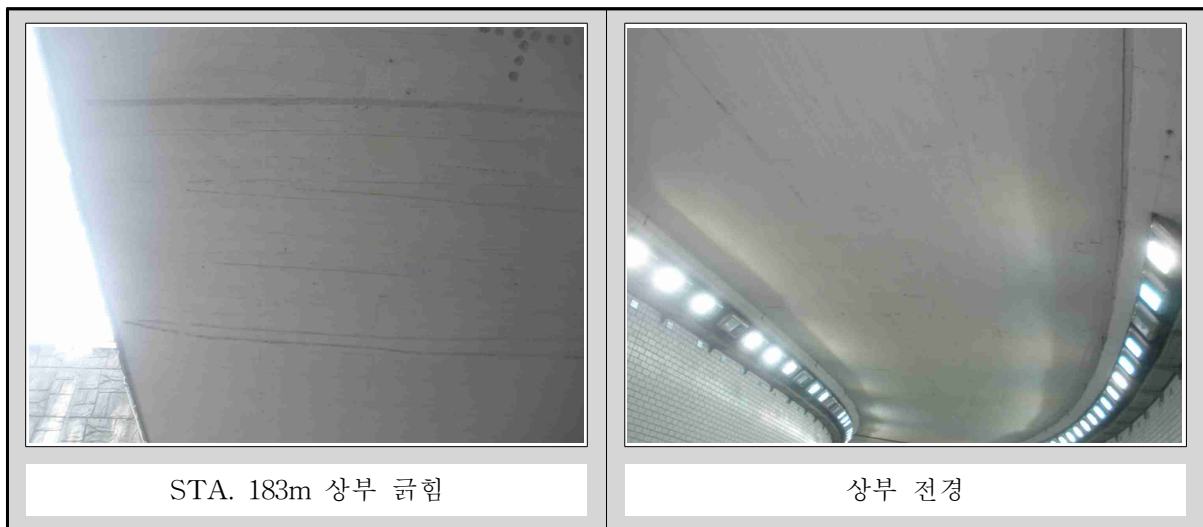
【표 2.1.1】 본선BOX 구간 상부슬래브 손상 및 결함내용
