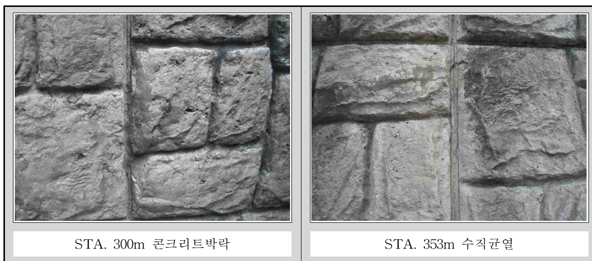
【표 2.1.5】 U-TYPE 옹벽 손상 및 결함내용
