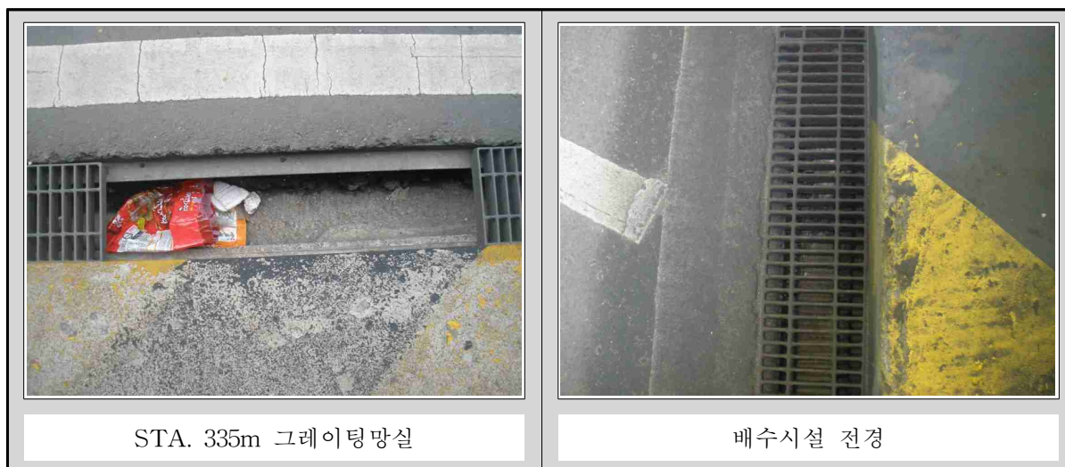
【표 2.1.11】 배수시설 손상 및 결함내용
