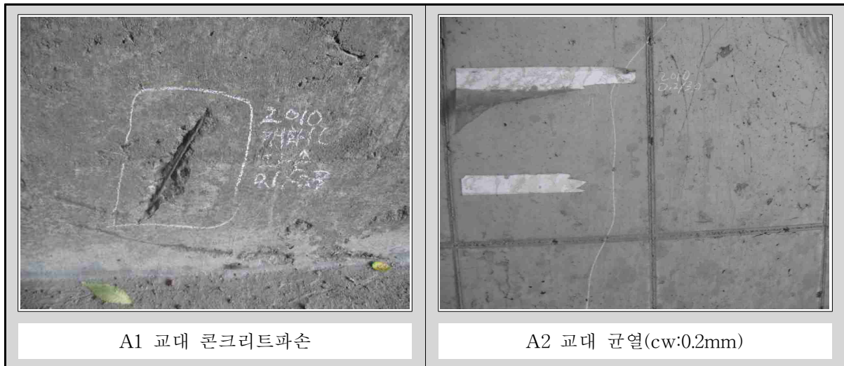
【표 2.1.3】 교대 및 기둥부 손상 및 결함내용
