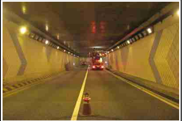
BOX 내부 전경
