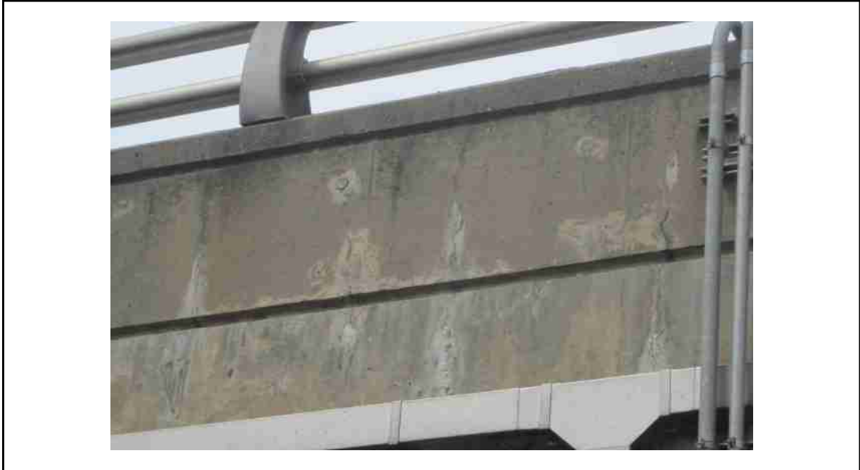
사진설명 지하차도 진출입 마감면 균열 및 균열부백태
