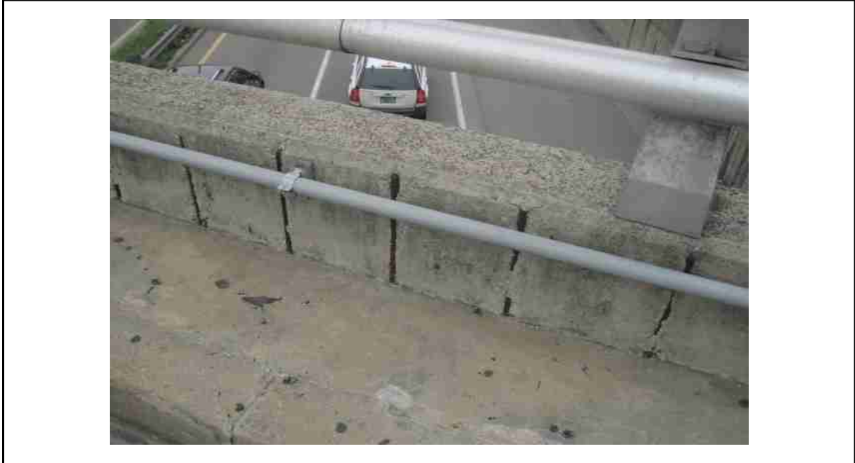
사진설명 지하차도 상부(난간벽) 철근노출(A=0.4m×22.0m)
