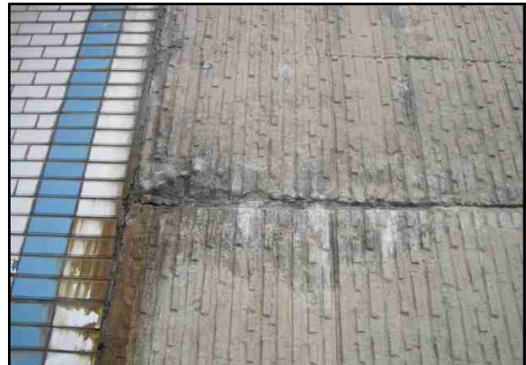
▶ 위치 : 옹벽(STA. 0+208m, 성산방향) ☞ 현황 : 백태(A=0.5mx1.6m)
