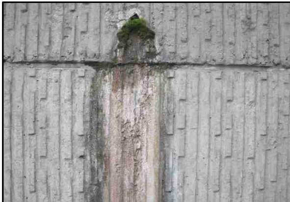
▶ 위치 : 옹벽(STA. 0+142m, 성산방향) ☞ 현황 : 배수공 주변 백태(A=0.5mx1.5m)
