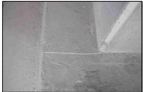
▶ 위치 : 하부거더 ☞ 현황 : 건조수축균열(c/w=0.3mm미만)
