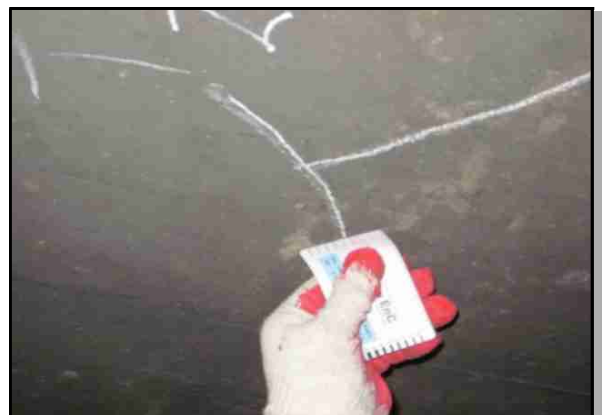
▶ 위치 : 상부슬래브 하면(STA.0+152) ☞ 현황 : 균열(c/w=0.3mm 이상)
