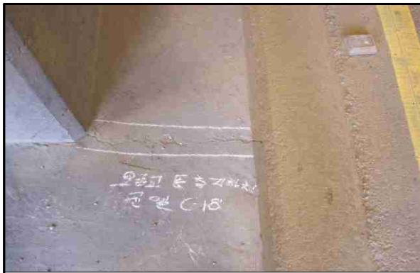
▶ 위치 : 하부거더(C-18) ☞ 현황 : 건조수축균열(c/w=0.3mm미만)
