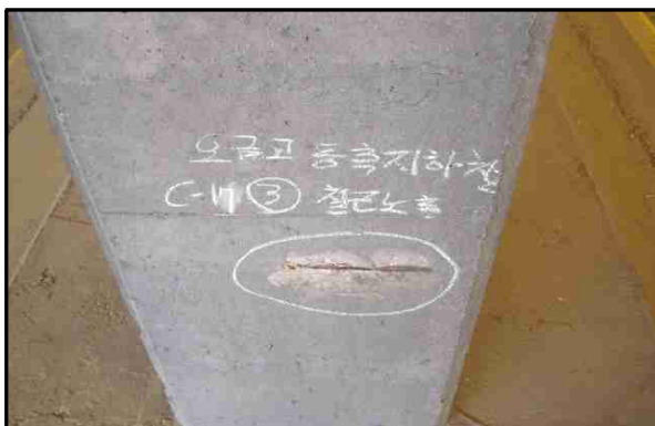
▶ 위치 : 기둥부(C-17-③, 배면) ☞ 현황 : 피복부족, 부식에 의한 철근노출
