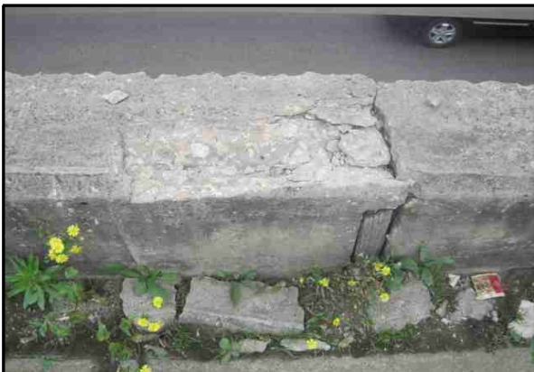
▶ 위치 : 옹벽(STA. 0+215m, 안양방향) ☞ 현황 : 배면 콘크리트 파손(A=0.3mx0.3m)
