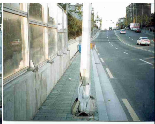
A1 좌측 가로등 파손 및 전도
