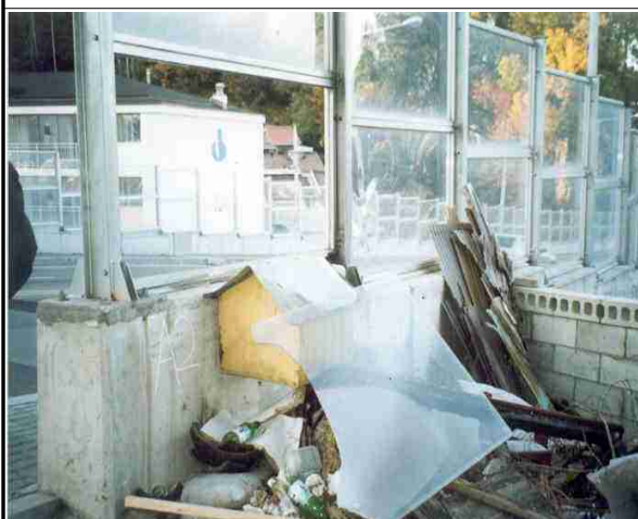
A2 우측방음벽 파손
