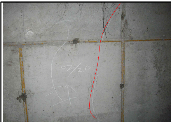
• 위치 : 교대(A1) • 현황 : 균열(cw:0.2mm) ◎대책방안 : 주의관찰
