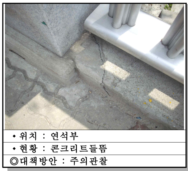
【사진 2.2.11】 손상현황(난간 및 연석)
