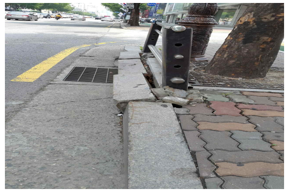
청소행정과 - 논현로 보도경계석 파손
