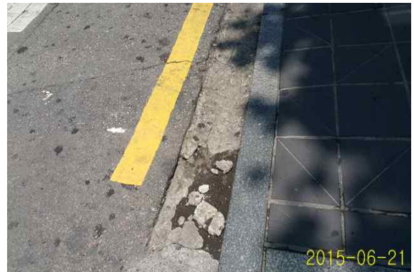
치수과 - 강남역 부근 도로 측구 파손
