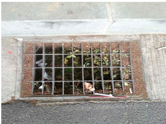
홍은동 옥천소공원 앞 거주자 주차구역 41-11 (막힘)
