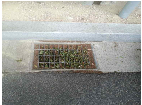
홍은동 옥천소공원 앞 거주자 주차구역 41-7 (막힘)
