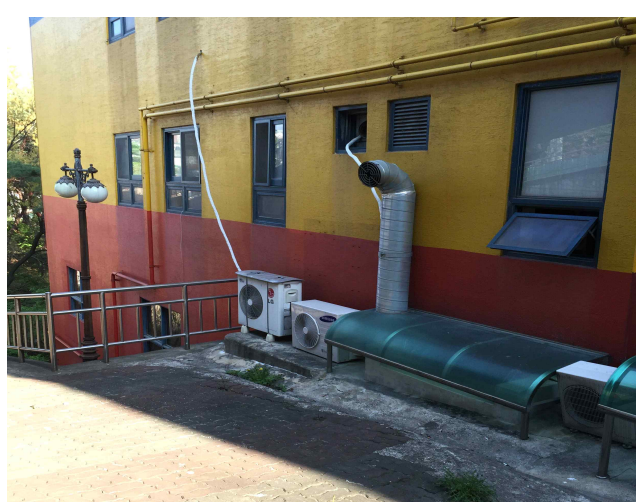
<정릉종합사회복지관 환풍구 관리사진>
