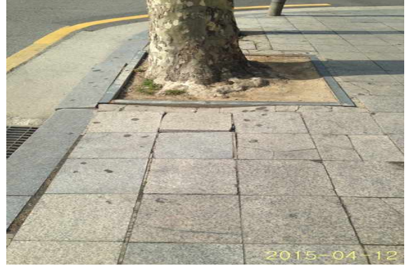
도시계획과 - 강남대로 보도블럭 파손
