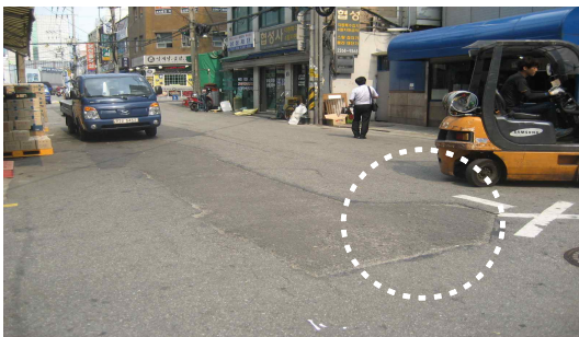
차도 부분복구사례(침하, 교면 균열 우려)
