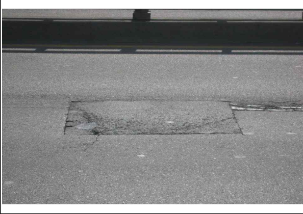
교면포장 보수부 파손 (본교-S5)
