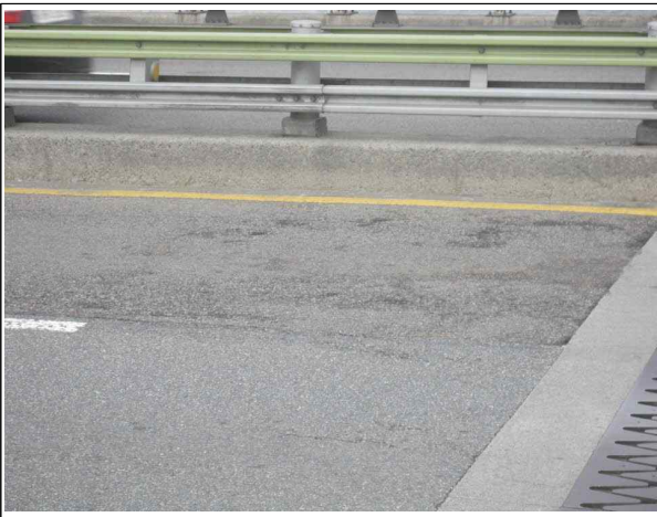
교면포장 마모 (본교-S10)
