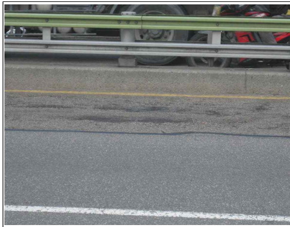
교면포장 망상균열 (본교-S 3 )
