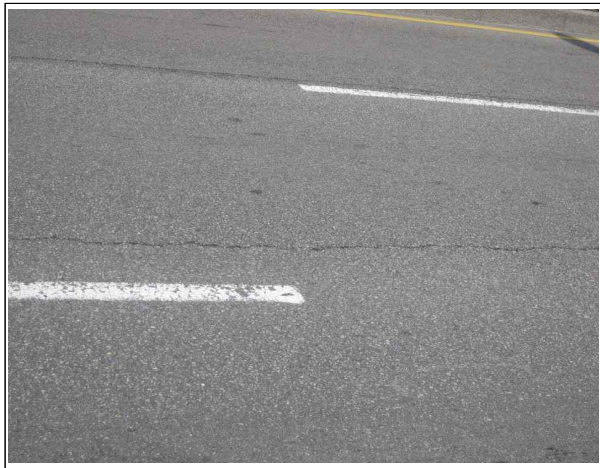
교면포장 균열 (본교-S11)
