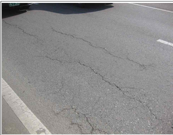
교면포장 망상균열 (본교-S 1 )
