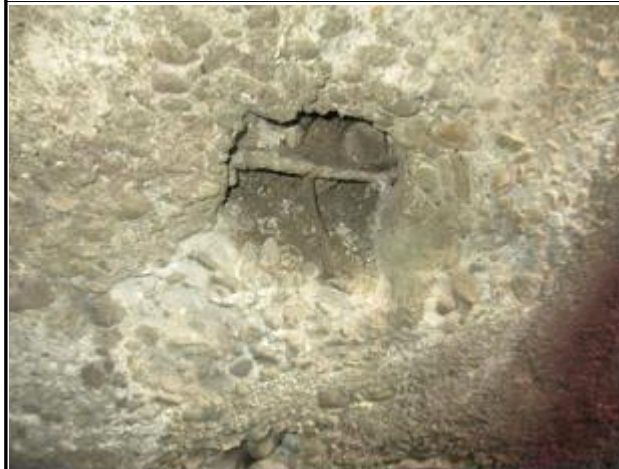
7라인 8.0m 벽체 관주변 파손, 철근노출
