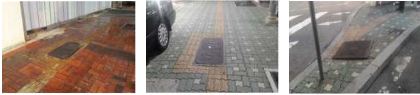
맨홀 돌출(높이불량) 맨홀높이조정 불량(침하) 맨홀 횡단보도앞 돌출시공
