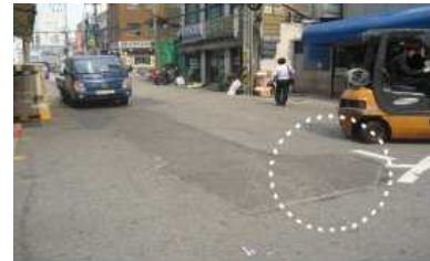
차도 부분복구사례(침하, 교면 균열 우려)
