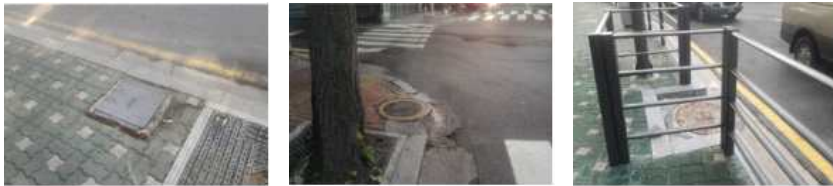
맨홀 비규격품 사용(돌출) 맨홀설치위치 불량(관리곤란) 맨홀위치 불량(보행환경불편)
