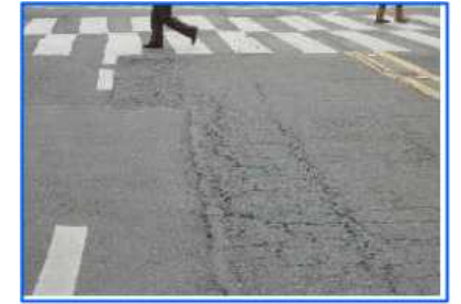
도로굴착복구 시공부위 균열불량 도로굴착복구 시공불량
