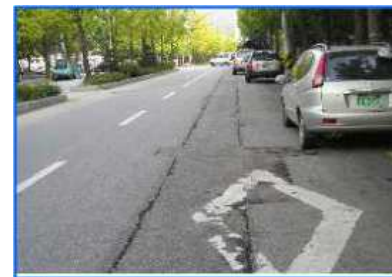
도로굴착복구 시공 접속부 불량 도로굴착복구 시공불량 및 침하
