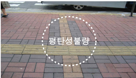
보도 부분복구사례(침하, 교면 균열 우려)
