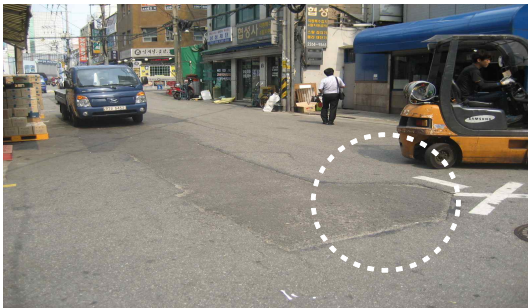
차도 부분복구사례(침하, 교면 균열 우려)
