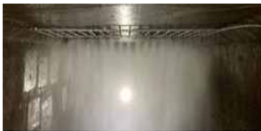
미세 물분사 악취저감시설
