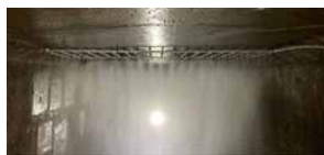
미세 물분사 악취저감시설
