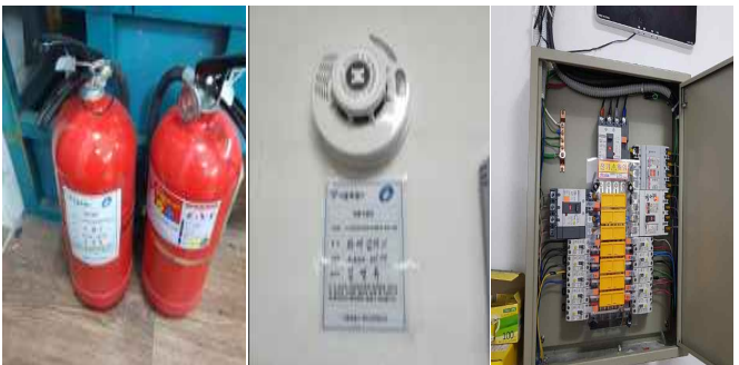
< 소화기 > < 화재감지기 > < 누전차단기 > 위해요소 개선(안전관리)
