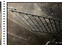
〈하수관로 스프레이식 악취저감시설, '20.9.〉
