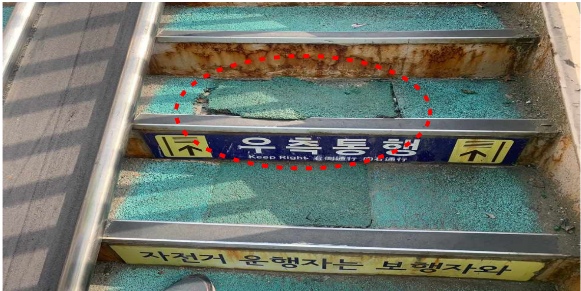
육교 계단 고무찰포장 파손 (철산교(광명시)→금천구(가산동)방향)
