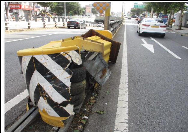
5-1: 군자교통측지하차도 충격흡수시설 파손
