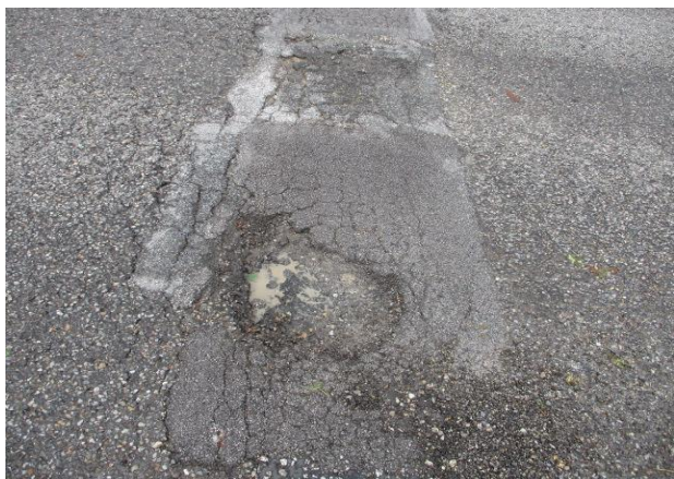
1-2: 청계천복개도로(우안) 신축이음부 소파
