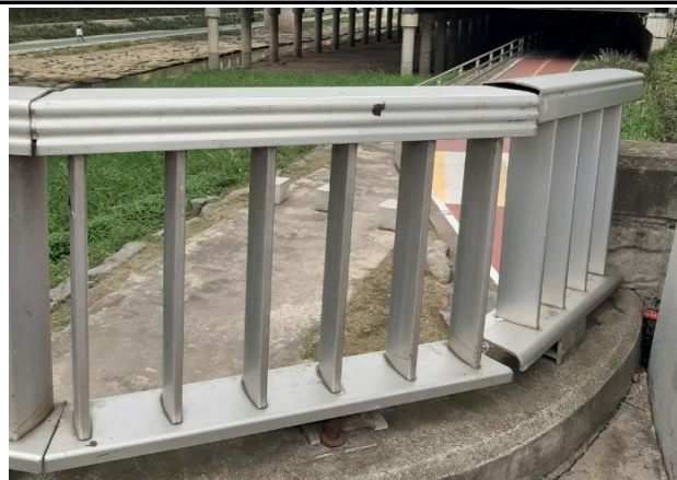
8-1: 용두교 인도난간 받침철물 파손
