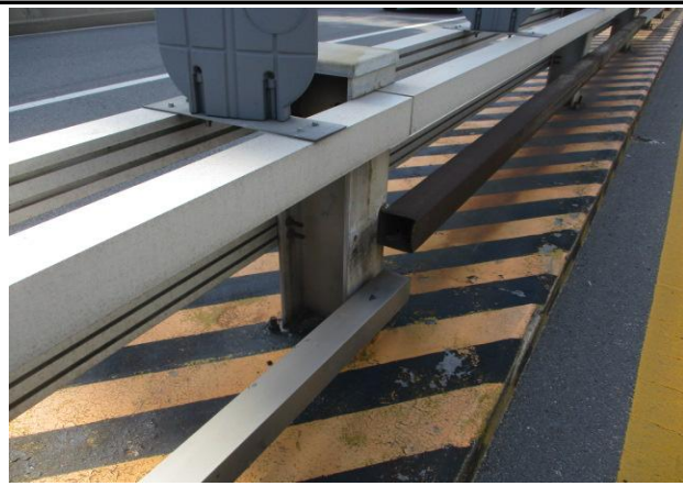
5-4: 군자교동측지하차도 중앙분리대 난간 이탈
