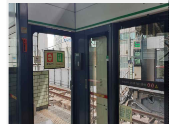
선로출입문 쇠정 상태
