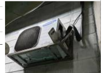
전원부 커버 탈락
