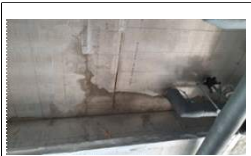
사진3. 피로티 천정 단열재 하부 페이스트 미 제거
