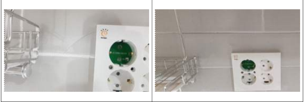
사진9. 203호 주방벽체 콘센트주위 타일 파손 사진9-1. 타일 파손부위 교체 재시공
