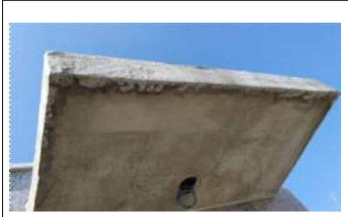
사진1. 옥탑 출입문상부 케노피 물끊기 홈 누락
