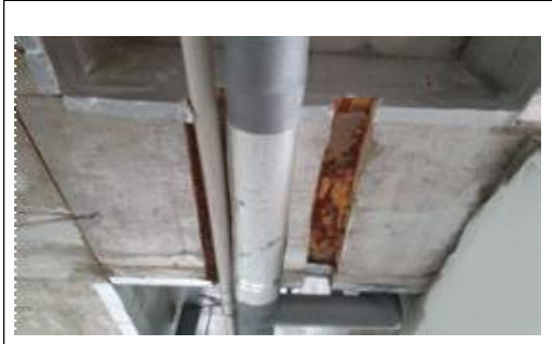
사진2. 피로티 천정 배관 수정부위 단열재 보완 누락
