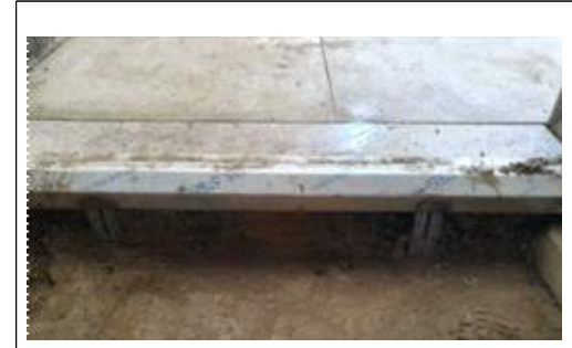
사진5. 세대 현관문틀 하부 채움 미비
