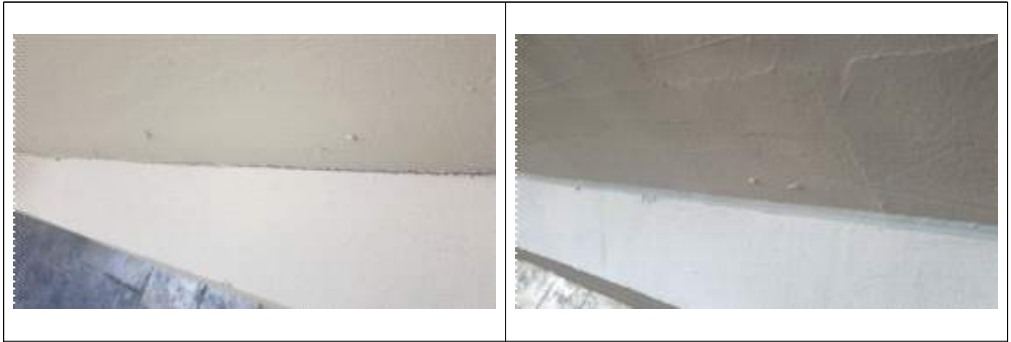
사진10. 인접대지 경계담장 하부 틈새 마감 미흡 사진10-1. 담장하부 틈새 코킹 마감 보완
