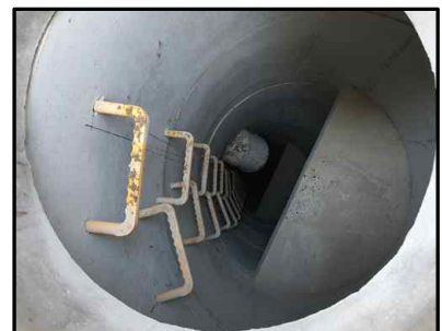
〈깊은맨홀 내 발판 설치〉
