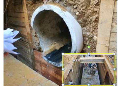
〈관로 끝단 파손〉
