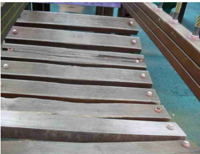
노후 파손된 구름다리
