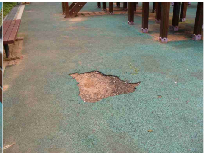
파손된 바닥 포장
