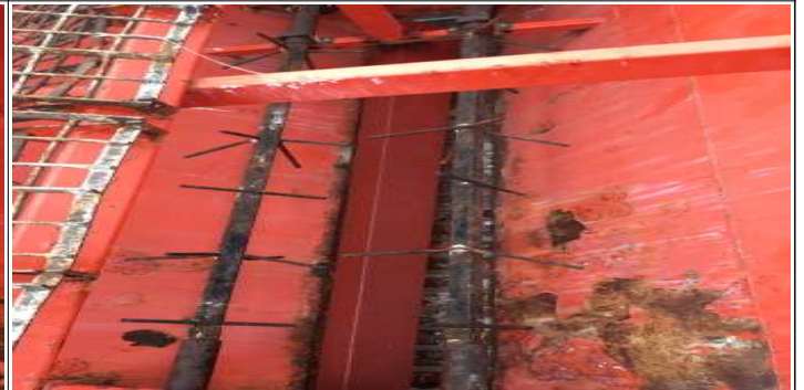
15톤살포기(1호) / 인버터 교환 후
