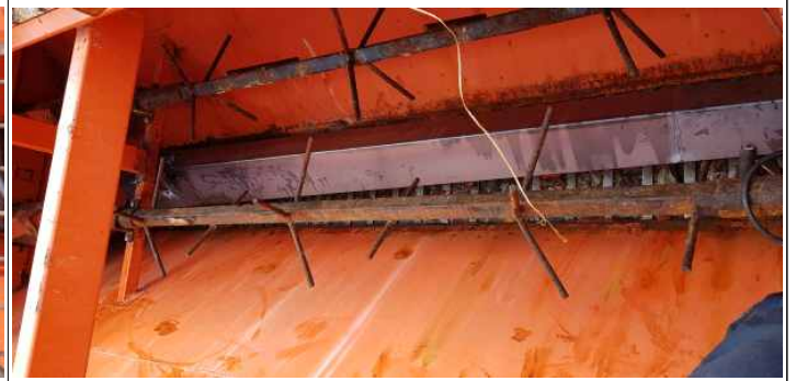
15톤살포기(6호) / 인버터 교환 후
