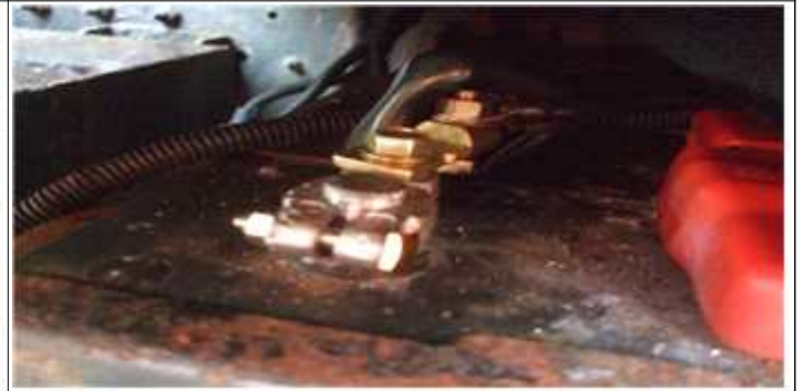
다목적차량(1163) / 배터리단자 교환 후
