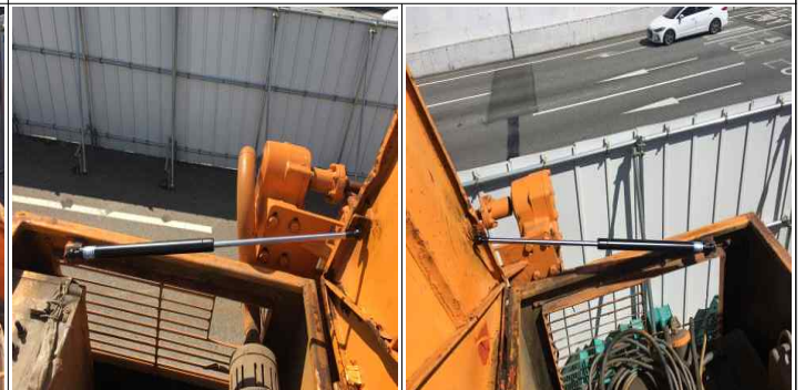
8톤살포기(4호) / 엔진룸 가스쇼바(운,조) 교환 후
