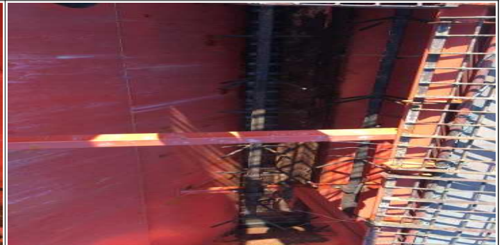
15톤살포기(5호) / 인버터 교환 후
