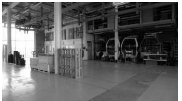
에미레이트 그리니치 페닌슐라역의 캐빈 정비실 내부 모습
