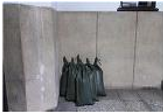
모래주머니 상태 양호
