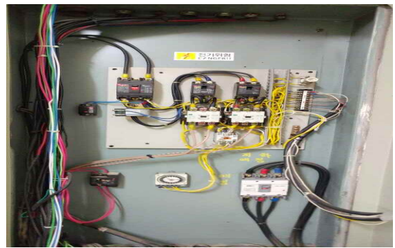
분전방 상태 양호
