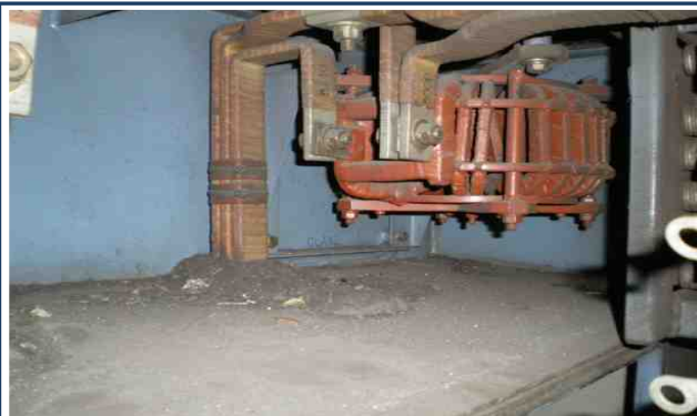
전기 평활장치 먼지 축적
