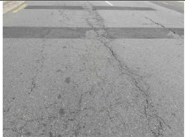
6. 침하 및 균열발생, 미끄럼방지 포장 파손
