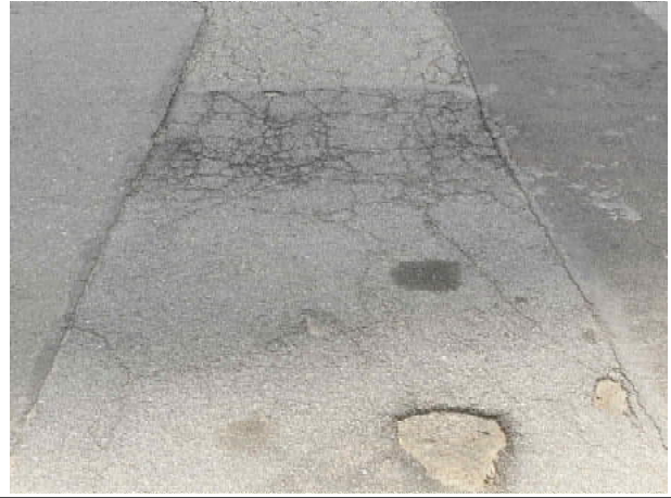
9. 굴착복구구간 균열 및 포트홀
