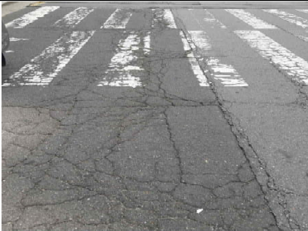
5. 거북등 균열 및 세로방향 균열
