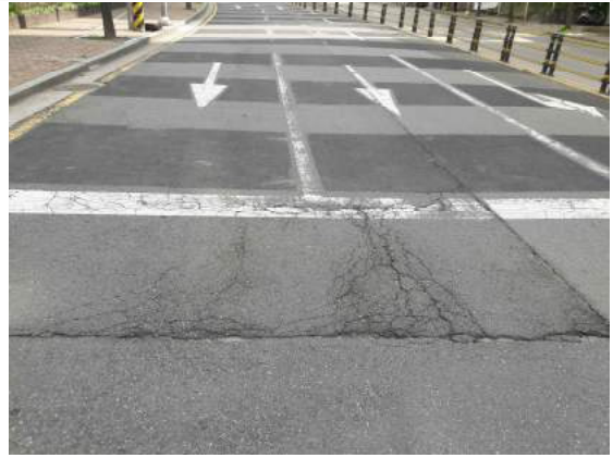
4. 균열 및 시공이음부 파손
