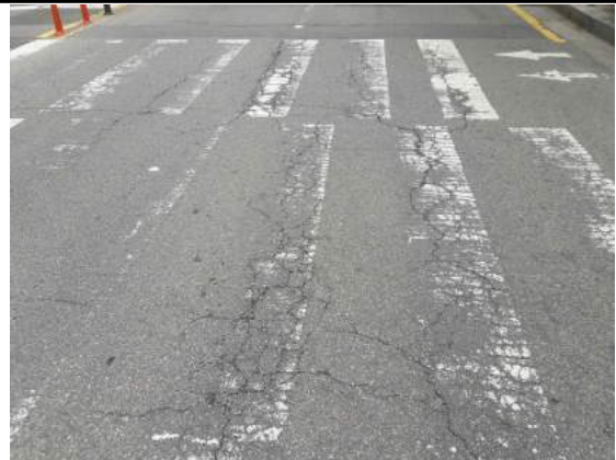
8. 횡단보도 세로방향 균열
