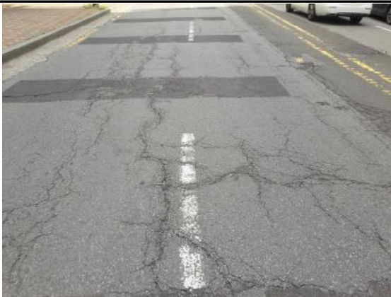
7. 세로방향 및 거북등 균열
