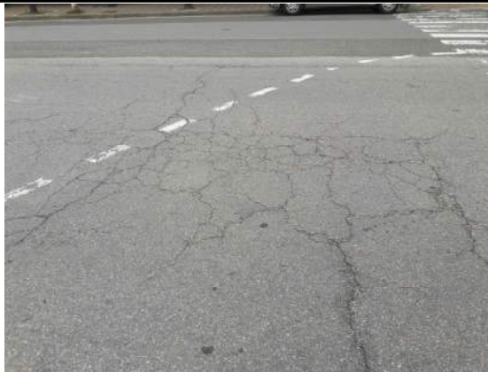
7. 신당 삼성아파트 진출입로 거북등 균열
