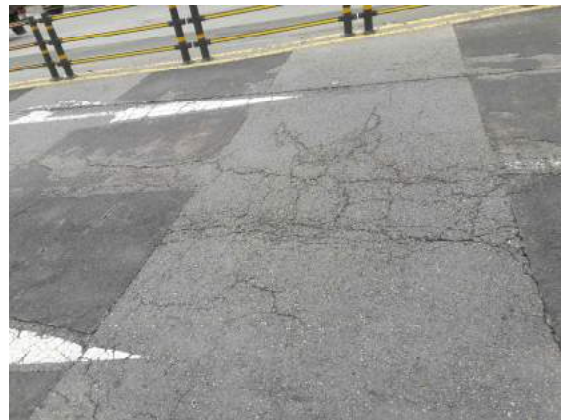
2. 거북등 균열 및 미끄럼방지 포장 파손
