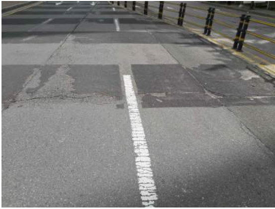
3. 세로방향균열 및 미끄럼방지 포장 파손
