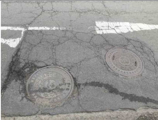
5. 맨홀 인근 균열
