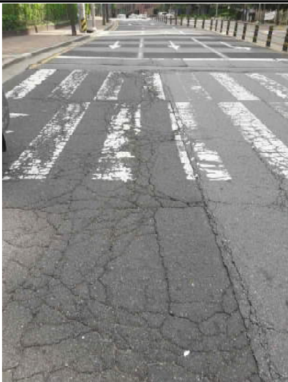
5. 거북등 균열 및 세로방향 균열
