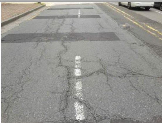
7. 세로방향 및 거북등 균열
