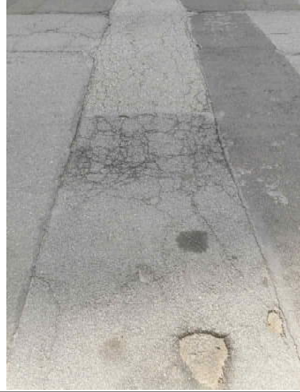
9. 굴착복구구간 균열 및 포트홀
