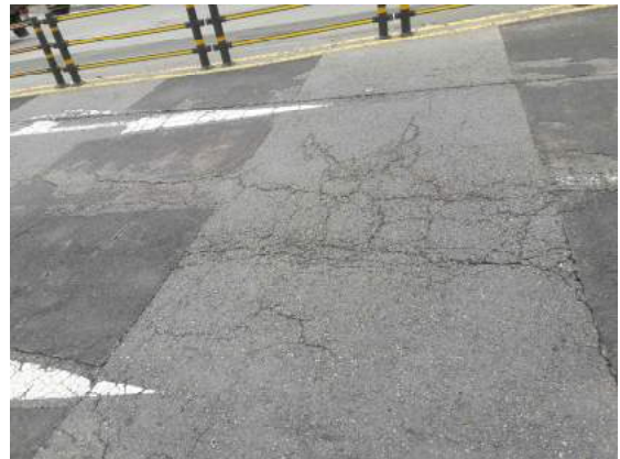
2. 거북등 균열 및 미끄럼방지 포장 파손
