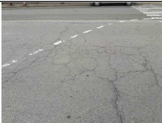
7. 신당 삼성아파트 진출입로 거북등 균열
