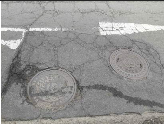
5. 맨홀 인근 균열
