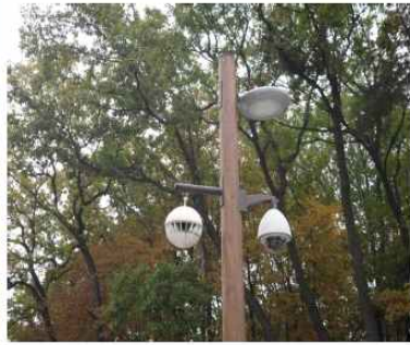
공원등 + CCTV + 스피커
