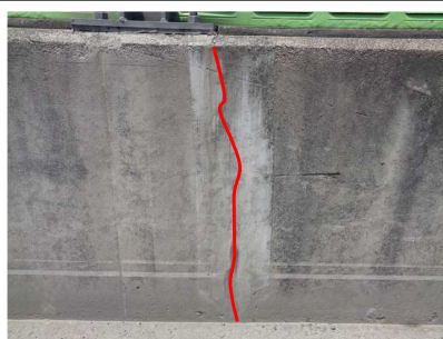
S29경간 방호울타리 보수부 재균열
