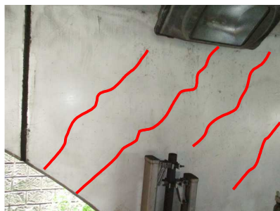
ARCH구간 S17경간 한남동측 아치부 내측 균열(c/w=0.1mm)
