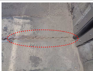
S28경간 신축유간 토사퇴적 및 신축이음장치 부식
