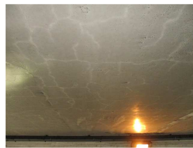
S26경간 슬래브하면 표면망상균열
