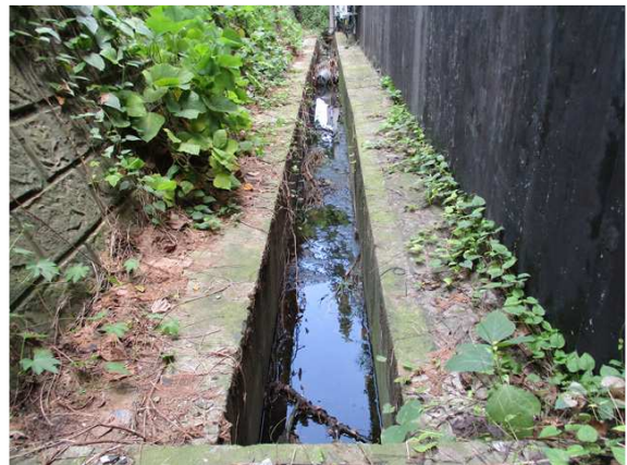
S30경간 U형측구 배수로 토사퇴적
