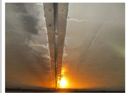
S23경간 신축이음부 누수흔적
