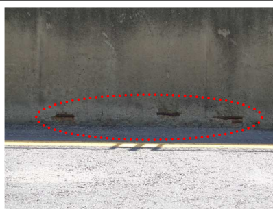
S16경간 방호울타리 철근노출
