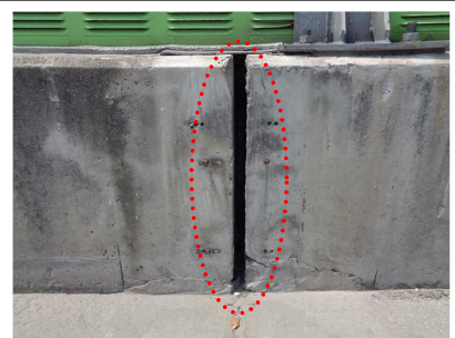
S50경간 차수덮개판 탈락
