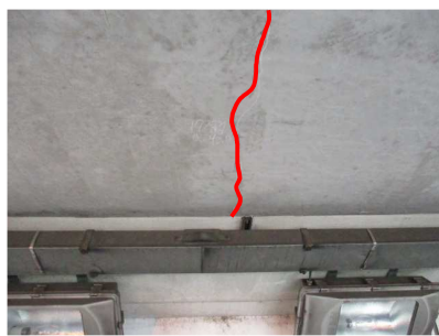
S8경간 슬래브하면 횡방향 균열(c/w=0.2mm)
