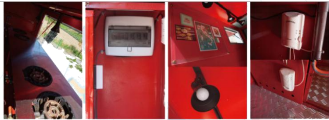
01 기본 가스 화구 4개 03 조명 및 인테리어 02 내부 배전 시설 04 가스유출 경보기
