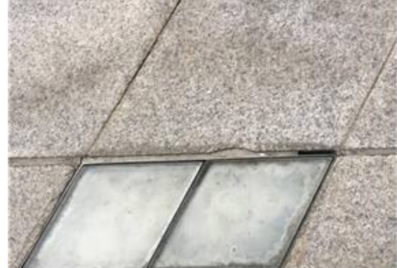
바닥 화강석 줄눈 오염 발생
