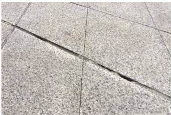
바닥 화강석 줄눈 탈락 발생
