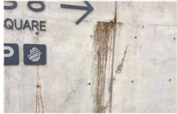
노출콘크리트 크랙 및 오염발생
