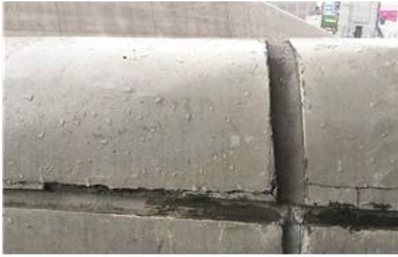
노출콘크리트 모서리각 파손
